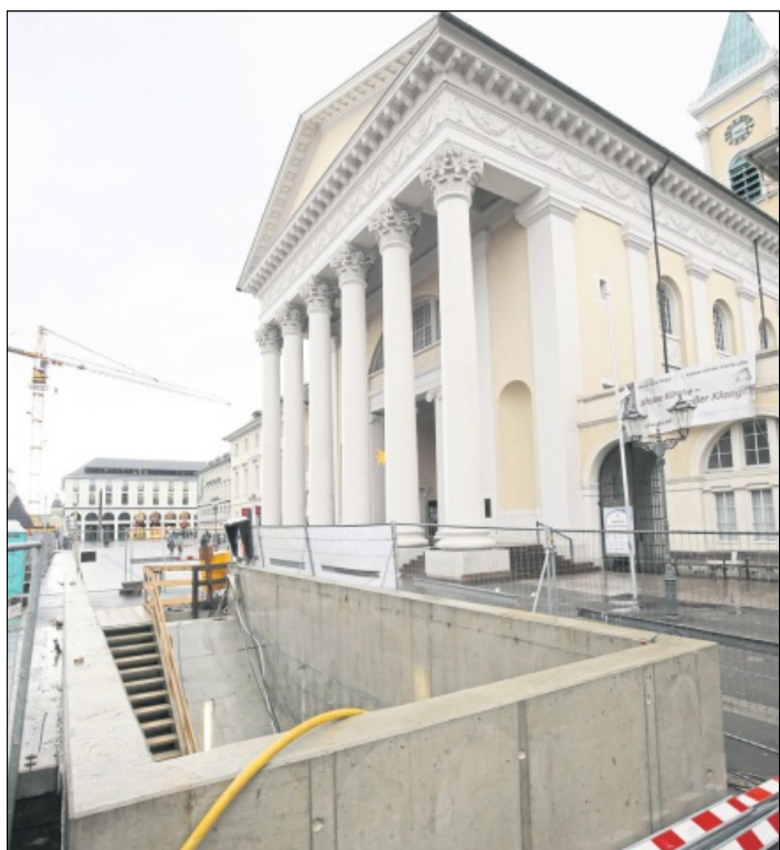
DIE BRÜSTUNG der U-Strab-Treppe vor den Säulen der Weinbrennerschen Stadtkirche sorgt für Entrüstung. Foto: jodo
